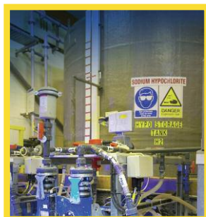
L'hypochlorite de sodium provoque des bouchons de vapeur dans de nombreux types de pompe
